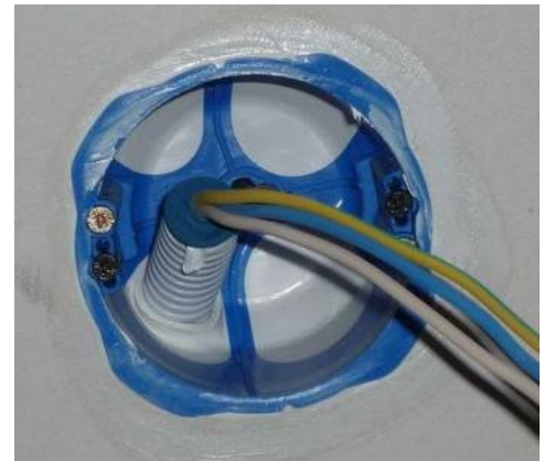
Les fuites d'air passent aussi par les prises électriques
